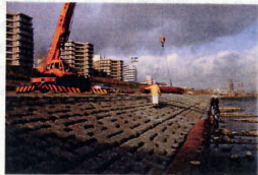
* クレーン(25t)での設置状況(法面はポーラスブロック) 固定はすべて椰子繊維の紐で施工
